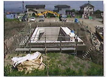
汚水処理施設
